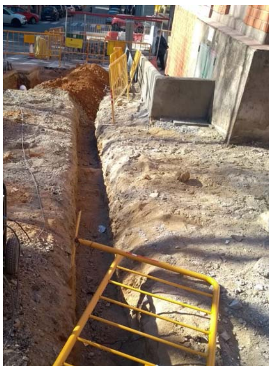
Fig.19 Detall del procés de rebaix de la rasa de serveis al tram V
