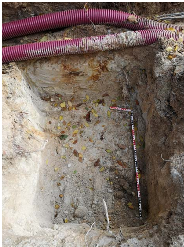
Fig.12 Detall del retall per a la fonamentació del fanal 2 en el tram II
