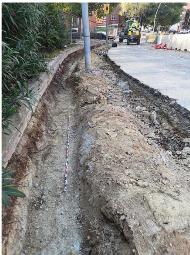
Fig.13 Detall de la rasa pel pas de cablejat elèctric al tram III.
